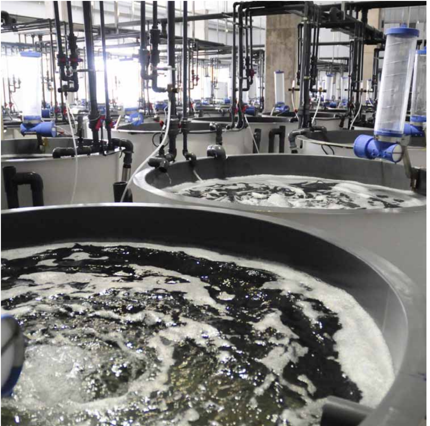
Instalaciones en el Parque Científico Tecnológico Marino de Taliarte
